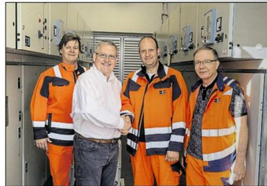
Freuen sich über die frühzeitige Inbetriebnahme des neuen Schalthauses: Oberrmonteur Christian Ohlendorf, Dr. Ulrich Schwarz, Projektleiter Christian Nolte und Zählermeister Günter Veron (von links nach rechts).
